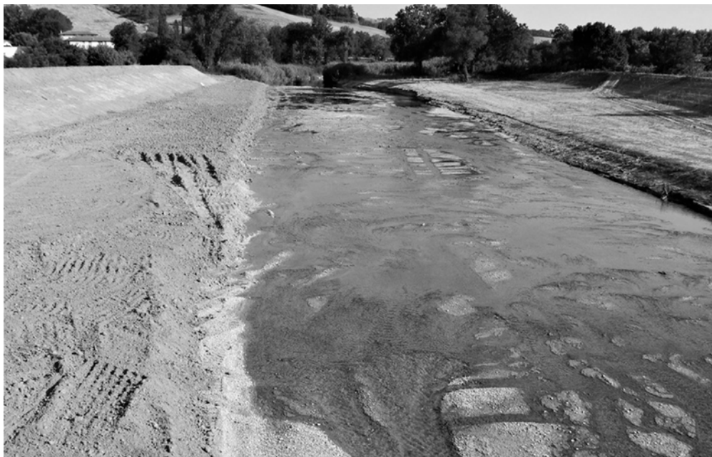
Fig. 8 - Un tratto del Fiume Misa dove sono stati completamente eradicati i boschi delle sponde (ancora visibili nel tratto a valle non ancora interessato dai lavori), oltre al completo rimodellamento e rettificazione del greto.
